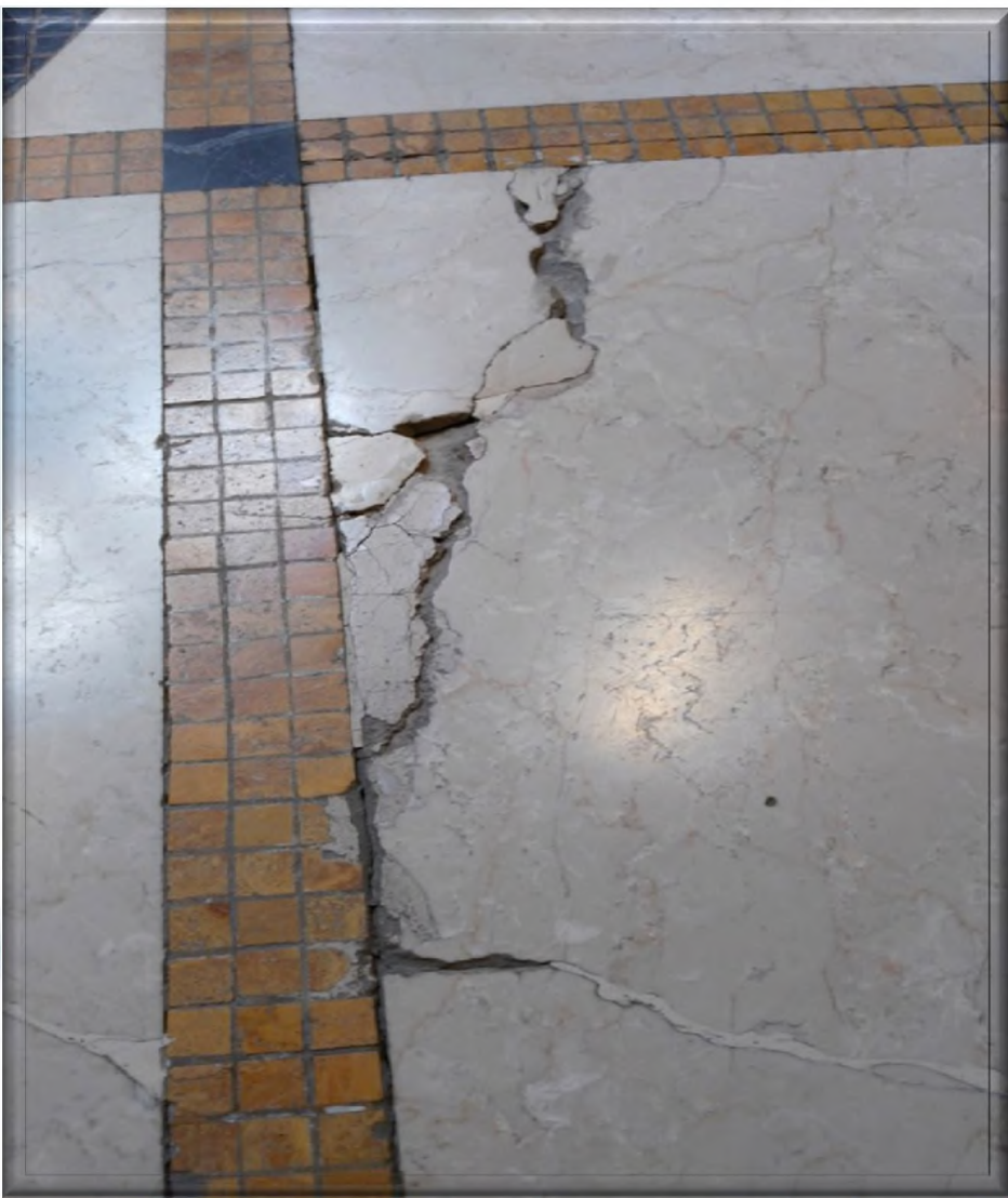
Трещина до ремонта
